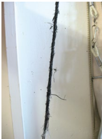
Ein völlig verschlissenes Tragseil hängt quasi am seidenen Faden. Das Tor wurde seit vielen Jahren weder fachgerecht überprüft noch gewartet.
