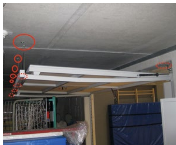
Gut! Die oberen Laufschiene sind in einwandfreiem Zustand. Die Aufhängung der Schienenkonstruktion wurde mit geeigneten und bauaufsichtlich zugelassenen Befestigungsmitteln in der massiven Betondecke befestigt. Somit ist dauerhaft sichergestellt, dass die Konstruktion sicher hält. Die spätere Kontrolle ist somit weniger aufwendig.
