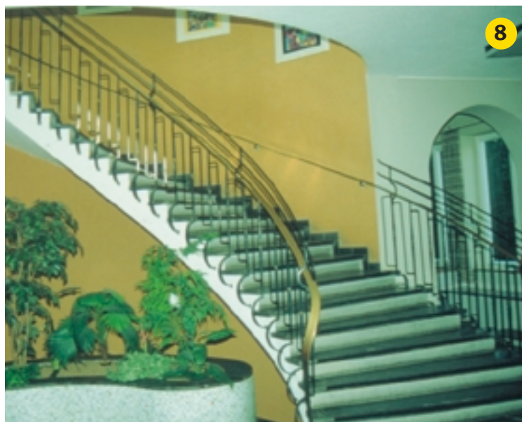
Dünne, seitlich versetzte Stäbe dienen gleichzeitig der Geländererhöhung und Sicherung gegen Rutschen.
