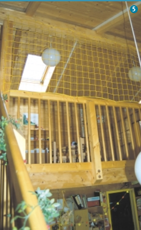
Netz als Absturzsicherung zwischen Umwehrung und Decke
