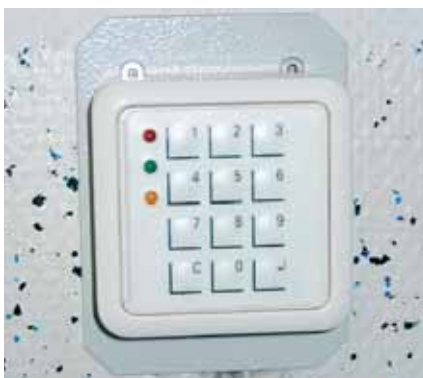
Bild 1: Unscharfschaltung des Personaleingangs mit Pin-Code
