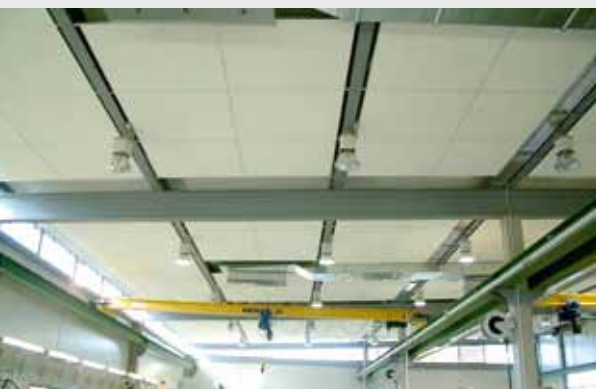
Waagrecht an der Decke aufgehängte Platten aus Absorptionsmaterial
