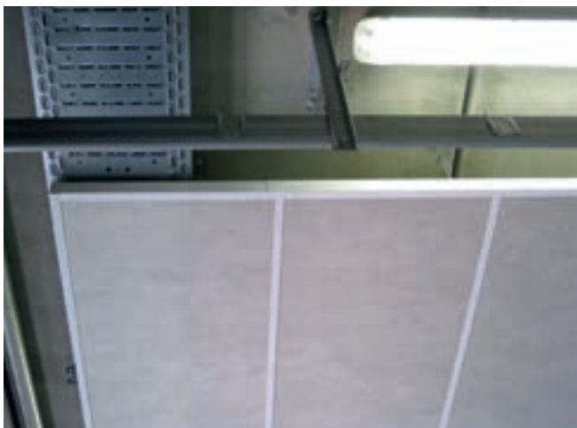
Bild 3: Akustikdeckenverkleidung von der vorhandenen Rohdecke abgehängt, Stärke 50 mm, Fläche 80 m²
