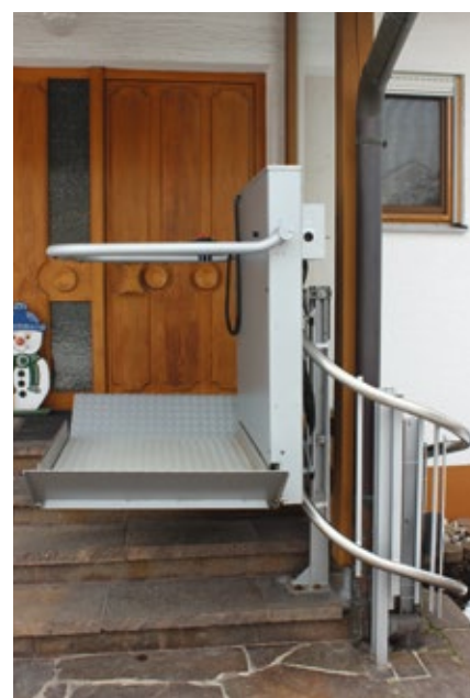
Ein Plattformlift im Eingangsbereich des Elternhauses ermöglicht Simon einen einfachen Zugang.
