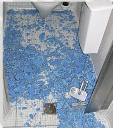
Abb. 6: ESG-Bruchbild – es zerfällt bei Glasbruch meistens vollflächig in viele kleine, stumpfe Teile. Hier ist eine WC-Glastür zerbrochen.
