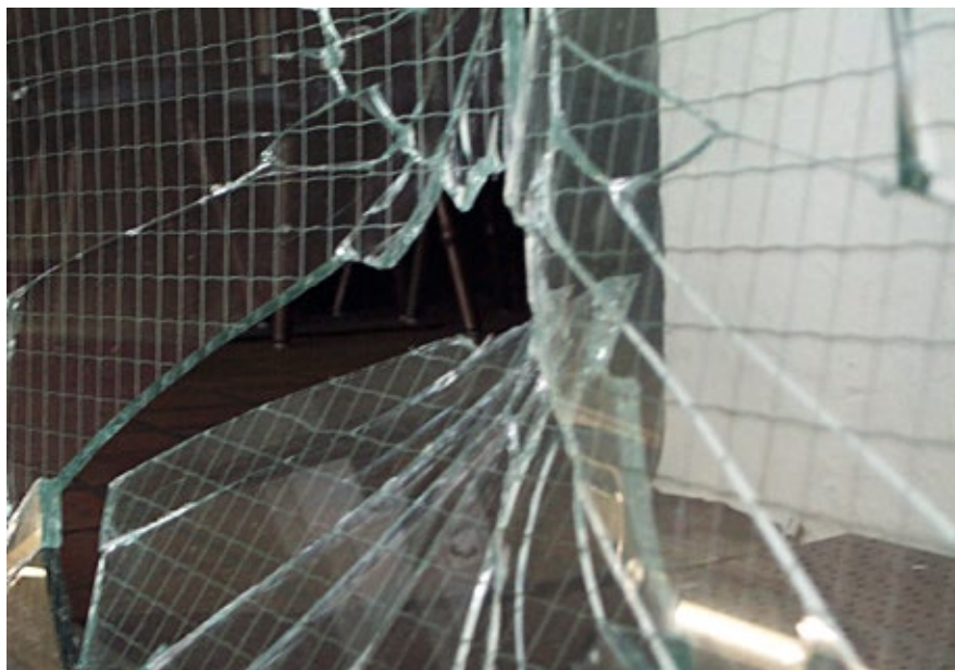
Abb. 9: Drahtglas – das Bruchbild zeigt die extreme Schnitt- und Verletzungsgefahr.
