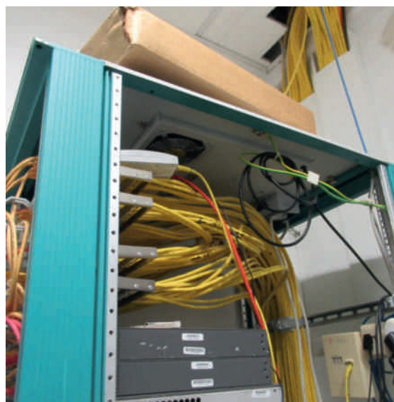
Abb. 1 und 2: Typische Situationen in Schulserverräumen; Kartonagen auf Serverschränken (links) oder Nutzung als Lagerraum (rechts) mit entsprechender erhöhter Brandanfälligkeit durch Kartonagen und Papier.
