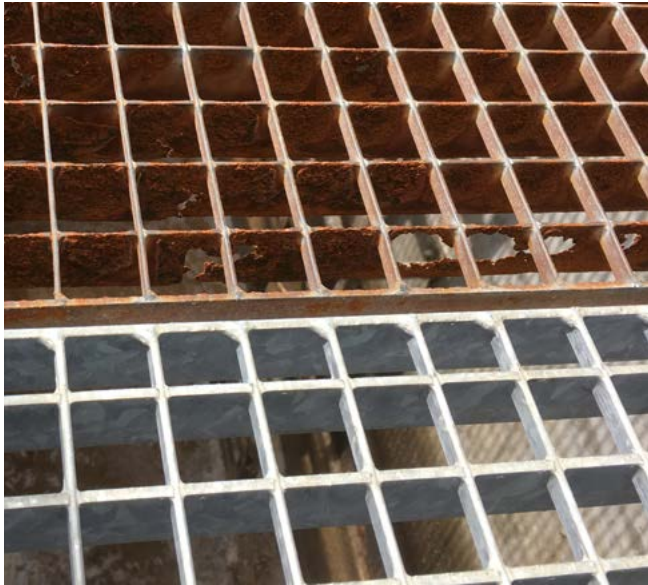
Lochfraß durch aggressive Atmosphäre/Kontaktkorrosion. Der obere Gitterrost muss dringend ersetzt werden. Hier sind in kürzeren Fristen konsequent Prüfungen erforderlich.
