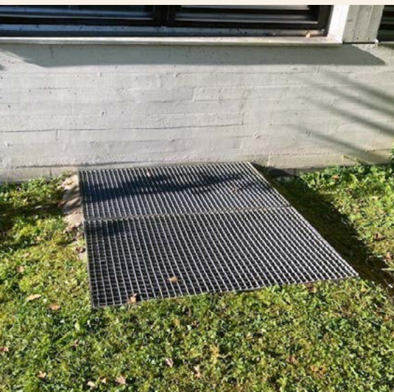
Hier passierte der Absturzunfall: Die Gitterrostabdeckung sieht von „außen bzw. oben“ augenscheinlich „sicher“ aus. Sowohl die fehlende Aushebesicherung, als auch der entfernte Mittelsteg waren von außen nicht erkennbar.
