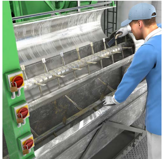
Abb. 73 Anlage gegen Einschalten gesichert
