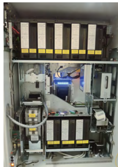
Öffnung der Rückseite des Bezahlautomaten im Technikraum
