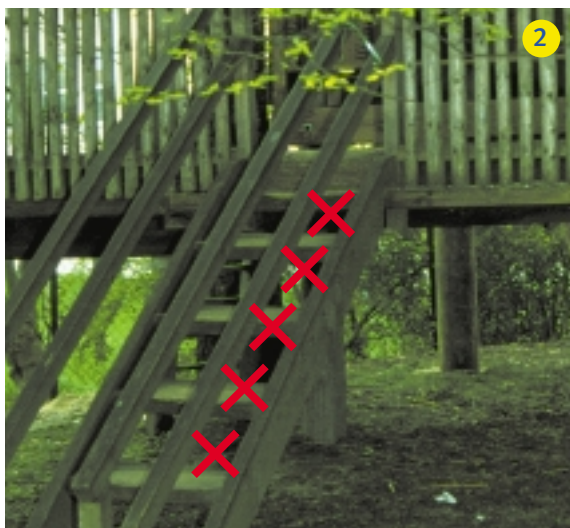
Abb. 2: Auch bei Treppen an Spielgeräten: keine lichten Weiten zwischen 11 cm und 23 cm
